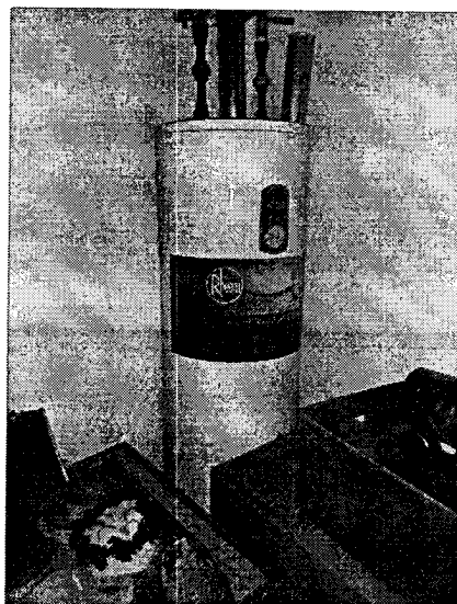
MANTENIMIENTO DE TERMOTANQUE EXISTENTE 150 LT.
